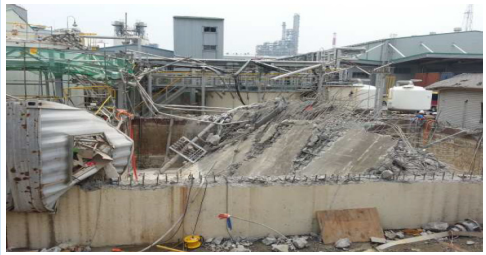
폐수 환경설비 구축공사 중 폭발 (‘15.7.3 사망 6, 부상 1)
