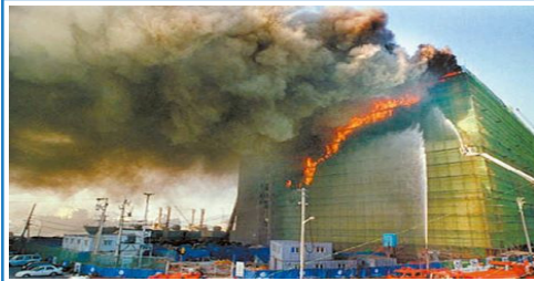
부산 냉동창고 신축공사 화재 (‘98.10.29 사망 27, 부상 16)
