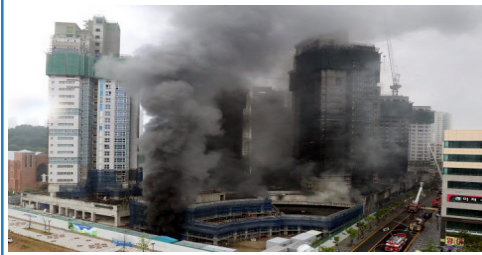
세종 주상복합 신축공사 중 화재 (‘18.6.26 사망 3, 부상 37)
