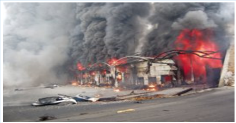
이천 물류 냉동창고 신축공사 화재 (‘08.1.7 사망 40, 부상 10)
