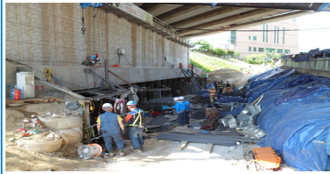
복선전철 교량 하부보강 중 LPG폭발 (‘16.6.1 사망 4, 부상 10)
